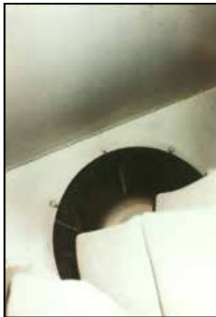
Clean Exhaust Fan
